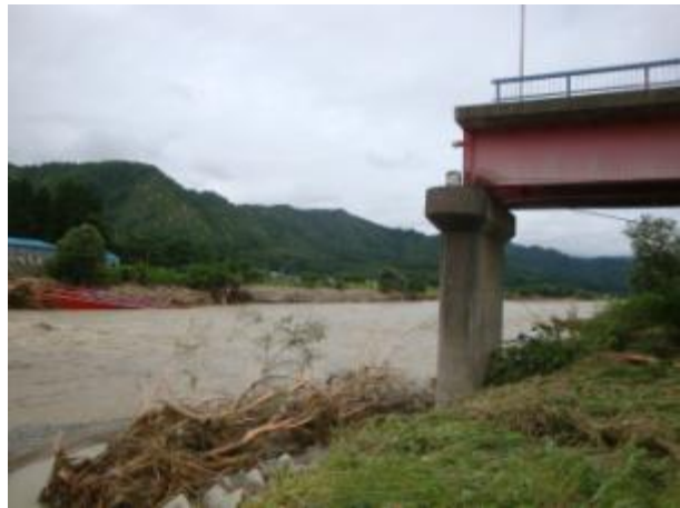
写真4：伊南川の氾濫により落ちた小川橋
