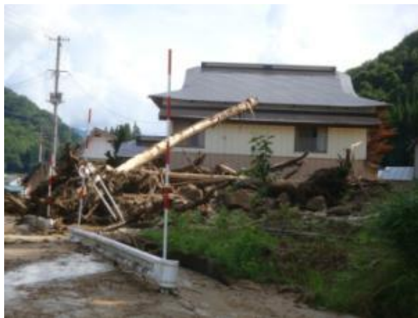
写真5：土石流の直撃を受けた家屋（二軒在家地区）
